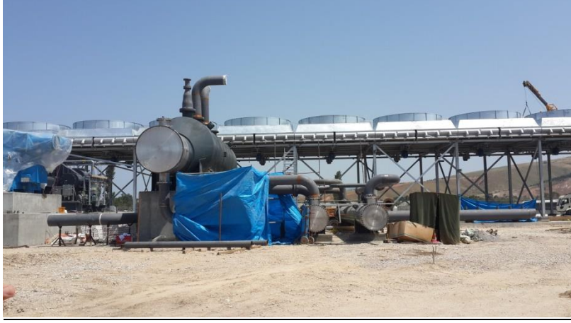
Jeotermal İnşaatı Soğutma Kuleleri Ve Türbinler
